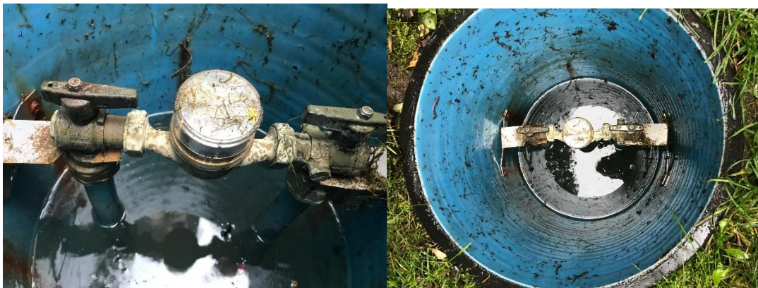
Eksempel på vandmålerbrønd.
